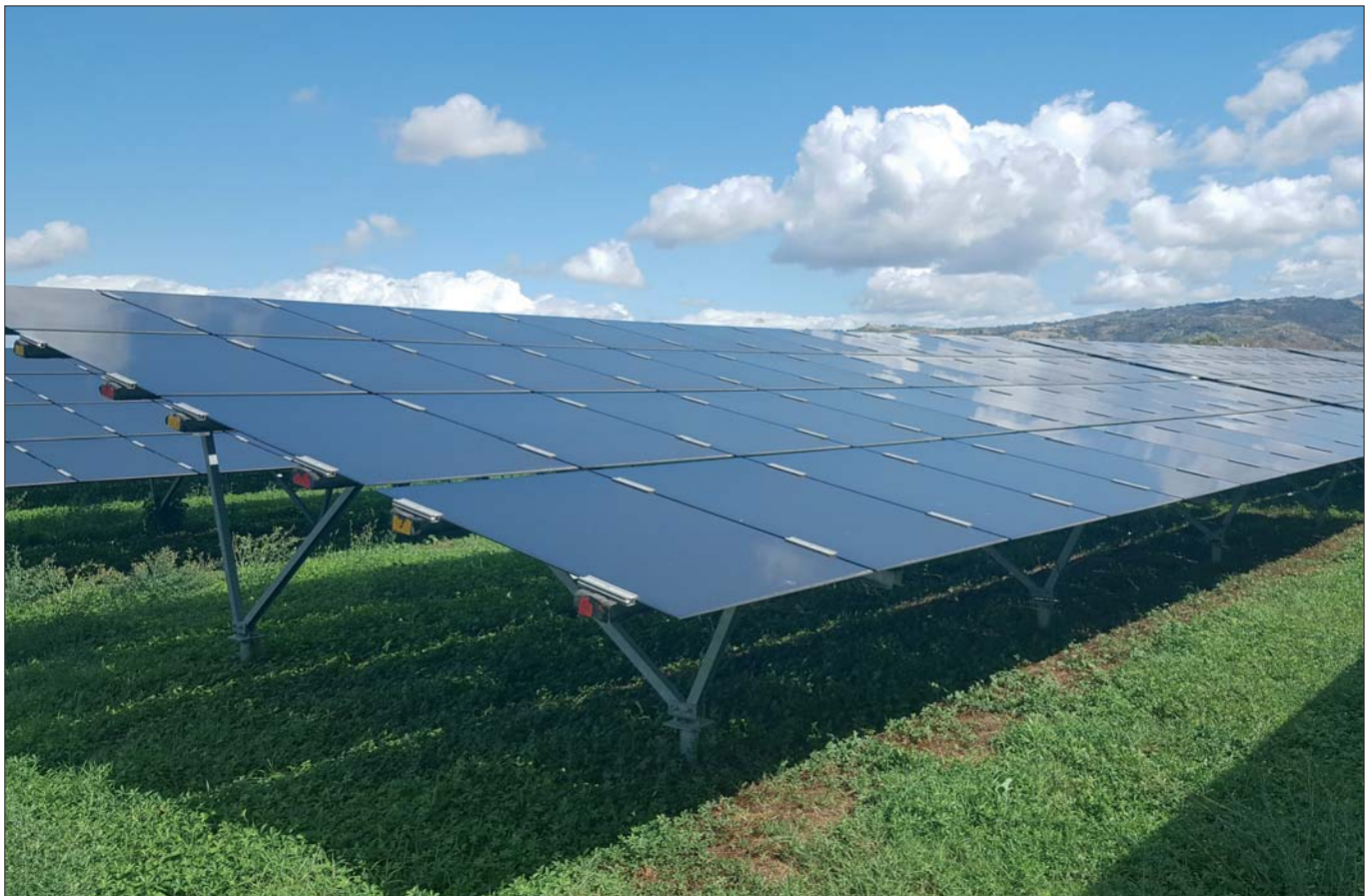
Impianto fotovoltaico a terra di EF Solare Italia S.p.A.
